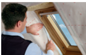
Dampremmer naar dakraam
